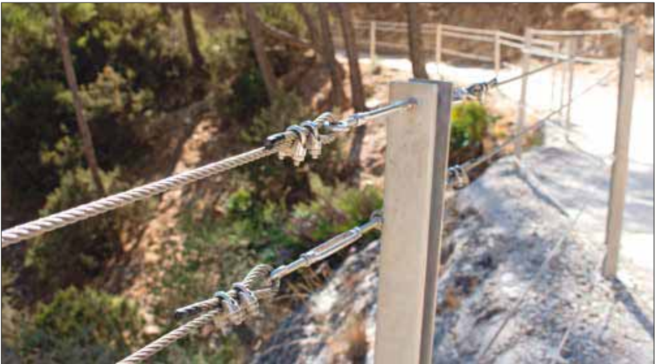
Barandilla realizada con pletinas y cables trenzados, ambos de acero inoxidable en el Caminito del Rey en Málaga.
