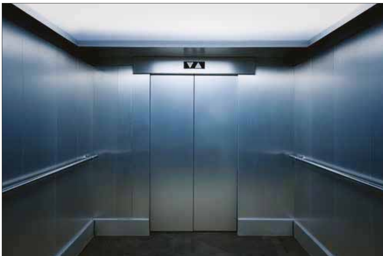
Interior de ascensor revestido con acero Inoxidable.
