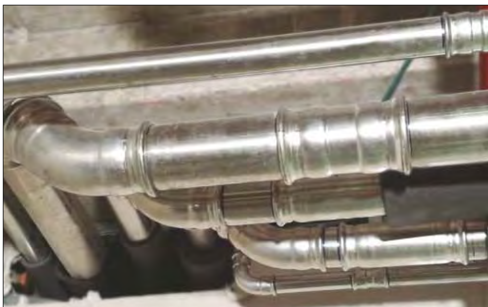
Tuberías de acero inoxidable.
